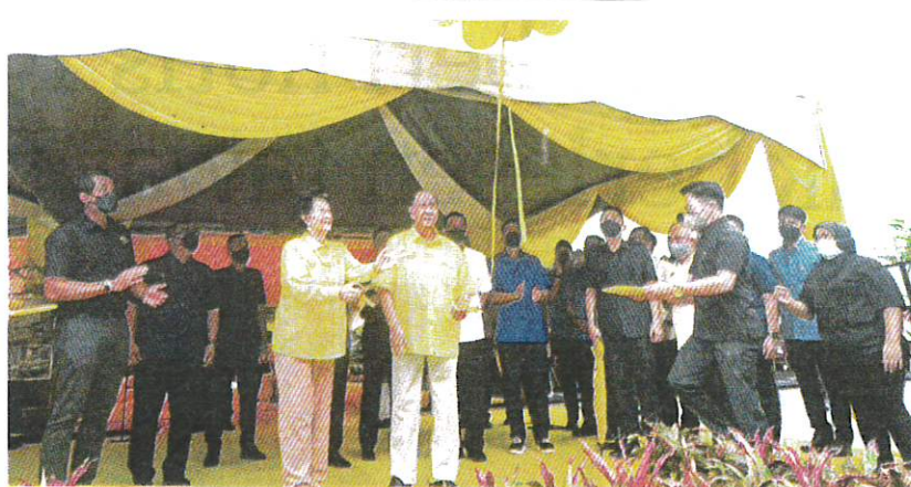
Sultan Sallehuddin diiringi Sultanah Maliha berkenan merasmikan Pecah Tanah Projek Pembinaan Bangunan Tambahan Hospital Sultanah Maliha di Langkawi, semalam. Turut hadir, Khairy, Menteri Kanan Kerja Raya, Datuk Seri Fadillah Yusof dan Muhammad Sanusi. (Foto BERNAMA)
